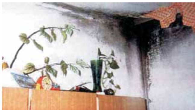
Zawilgocenie górnego naroża ścian w kuchni
