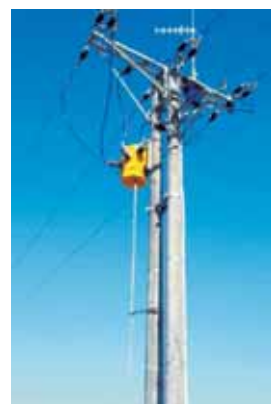
Rys. 2. Rozłącznik THO 24 zamontowany w linii średniego napięcia
