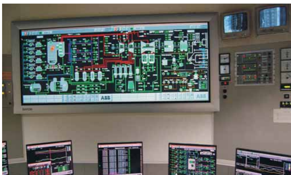
Główny punkt nadzoru i sterowania w elektrowni.
