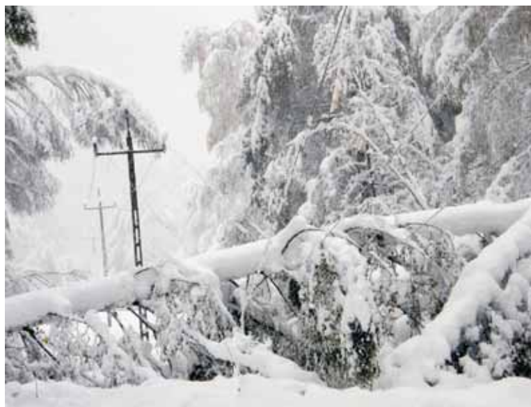
L15 kV Smolnik-Zatwarnica w m. Chmiel
