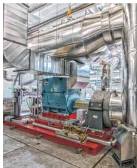
Turbina - generator Ciepłowni Łężańskiej
