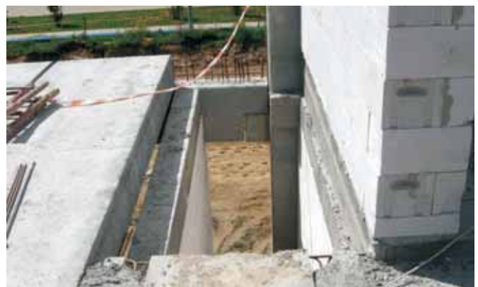
Brak zabezpieczających barier ochronnych.
