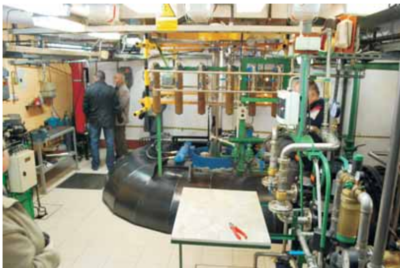
Wnętrze hali elektrowni wodnej
