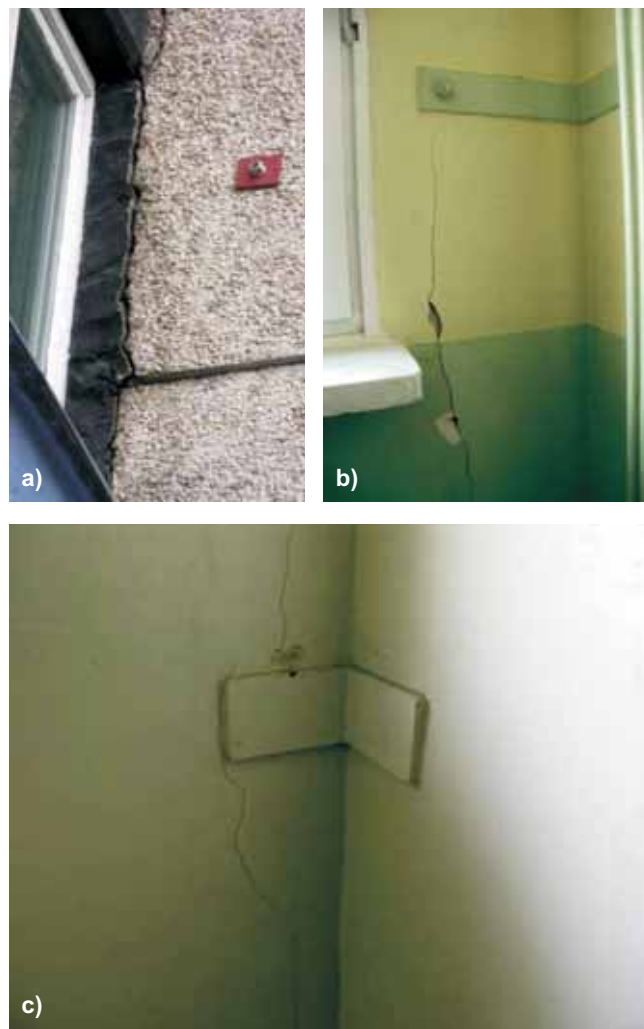
Rys. 3. Przykłady wzmocnień wykonanych w budynkach wielkopłytkowych: a) widok od strony zewnętrznej wzmocnienia przedstawionego na rys. 2b; b) uszkodzenia na ścianie ZWO od strony wewnętrznej budynku po zastosowaniu wzmocnienia; c) widok uszkodzeń po wykonaniu wzmocnienia 2c
