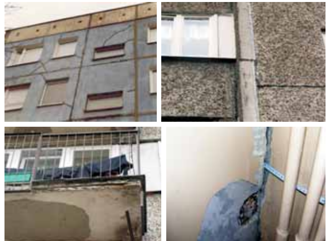
Rys. 1. Przykłady uszkodzeń elementów i złączy w budynkach wielkopłytyowych (fot. Jacek Dębowski)
