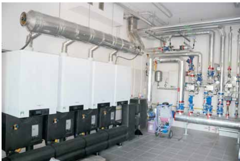
Kotłownia gazowa kondensacyjna Viessmann o mocy 600 kW w budynku produkcyjnym
