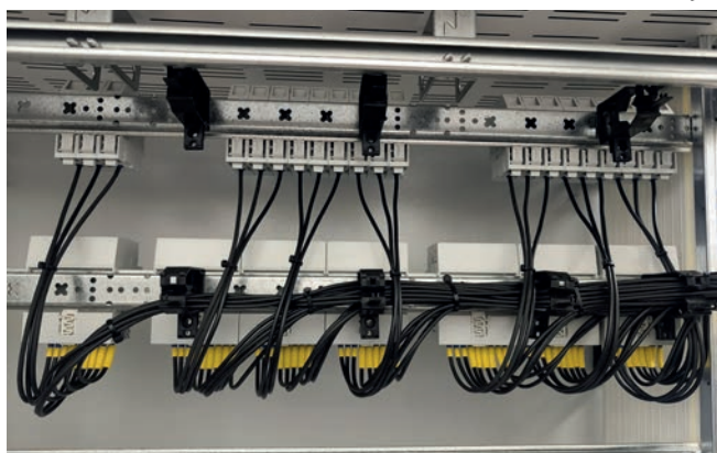
Foto. 2: Przykład ułożenia w powietrzu i wiązkach (zdjęcie wykonane od strony „pleców” rozdzielni).
