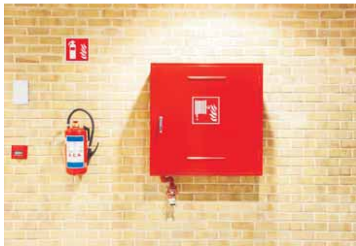
Rys. 3. Lokalizacja urządzeń przeciwpożarowych wymaga zwiększonego natężenia oświetlenia
