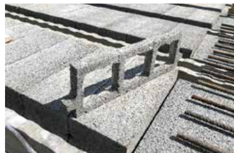
Fot. Docięty pustak betonowy
