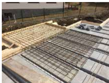
Fot. Strefa obniżona przy balkonie.
