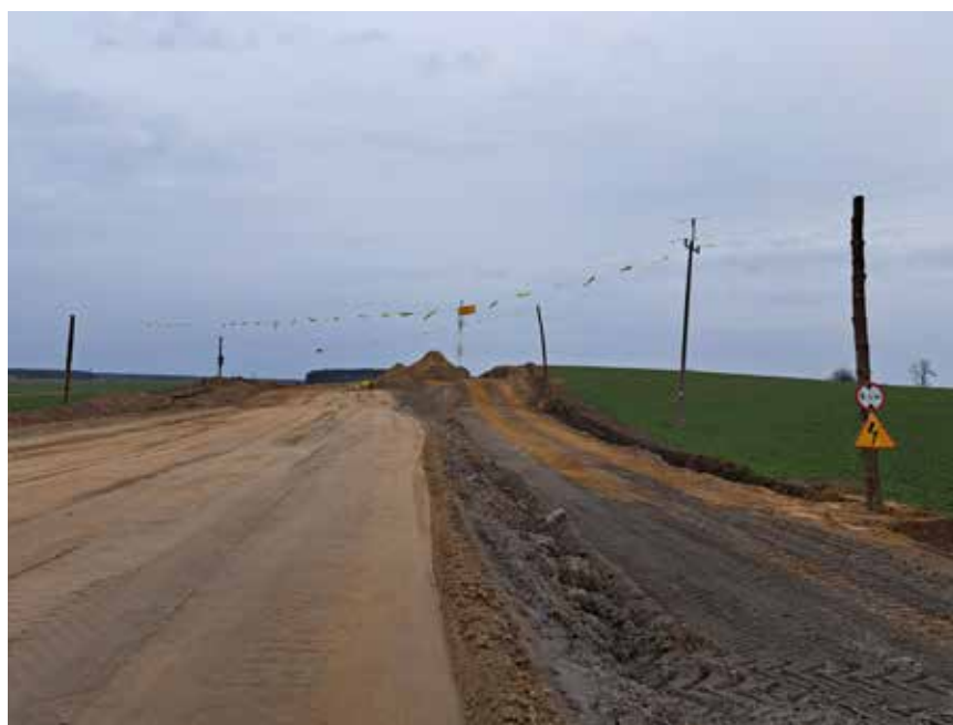
Rama zabezpieczająca przy kolizji z siecią napowietrzną
