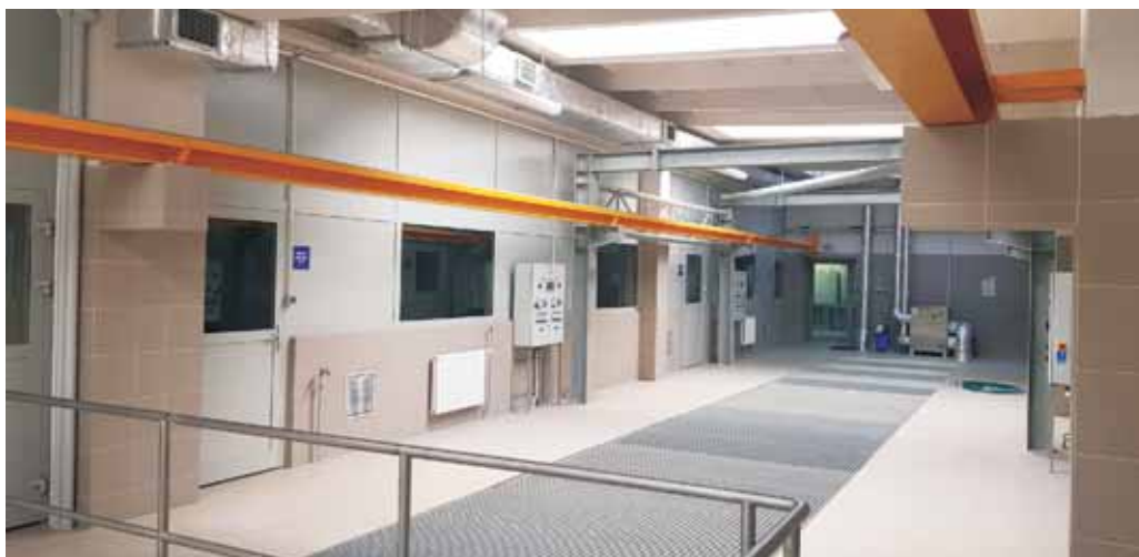
Hala filtrów II stopnia.
