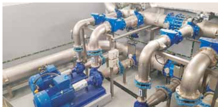
Pompownia wody do miasta
