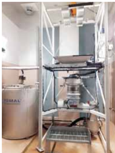
Stacja dozowania pylistego węgla aktywnego
