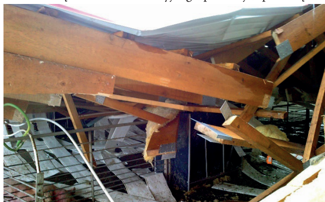
Rys. 10 Zawalony dach na fermie (MITEK)
