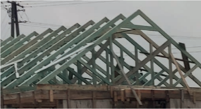
Rys. 3 Zamontowana więźba dachowa bez zaprojektowanych łączników (SAWE 4 )
