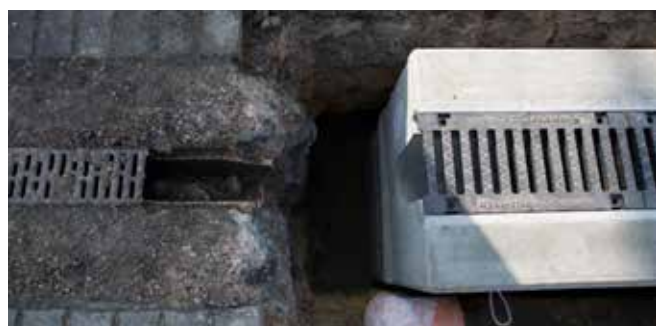
Fot. Archiwum HAURATON Polska - Porównanie skorodowanej opaski betonowej odwodnienia liniowego vs odwodnienie w prefabrykowanej obudowie żelbetowej
