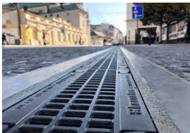
Fot. Archiwum HAURATON Polska – odwodnienie liniowe w prefabrykowanej obudowie ul. Karmelicka w Krakowie
