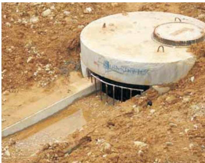
Przykład nieprawidłowego zabezpieczenia studni wpadowej – brak rampy ucieczkowej oraz zbyt duży rozstaw prętów
