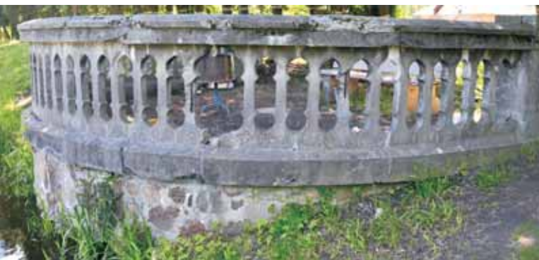
Stan zachowania elementów tarasu widokowego, 2013
