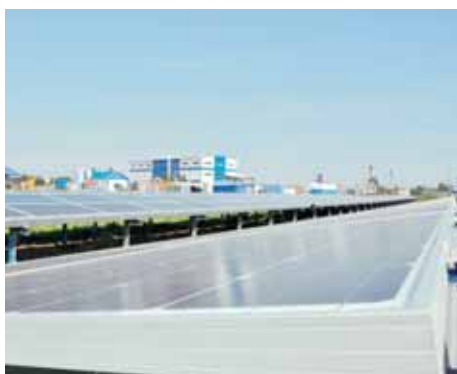
Widok na panele fotowoltaiczne
