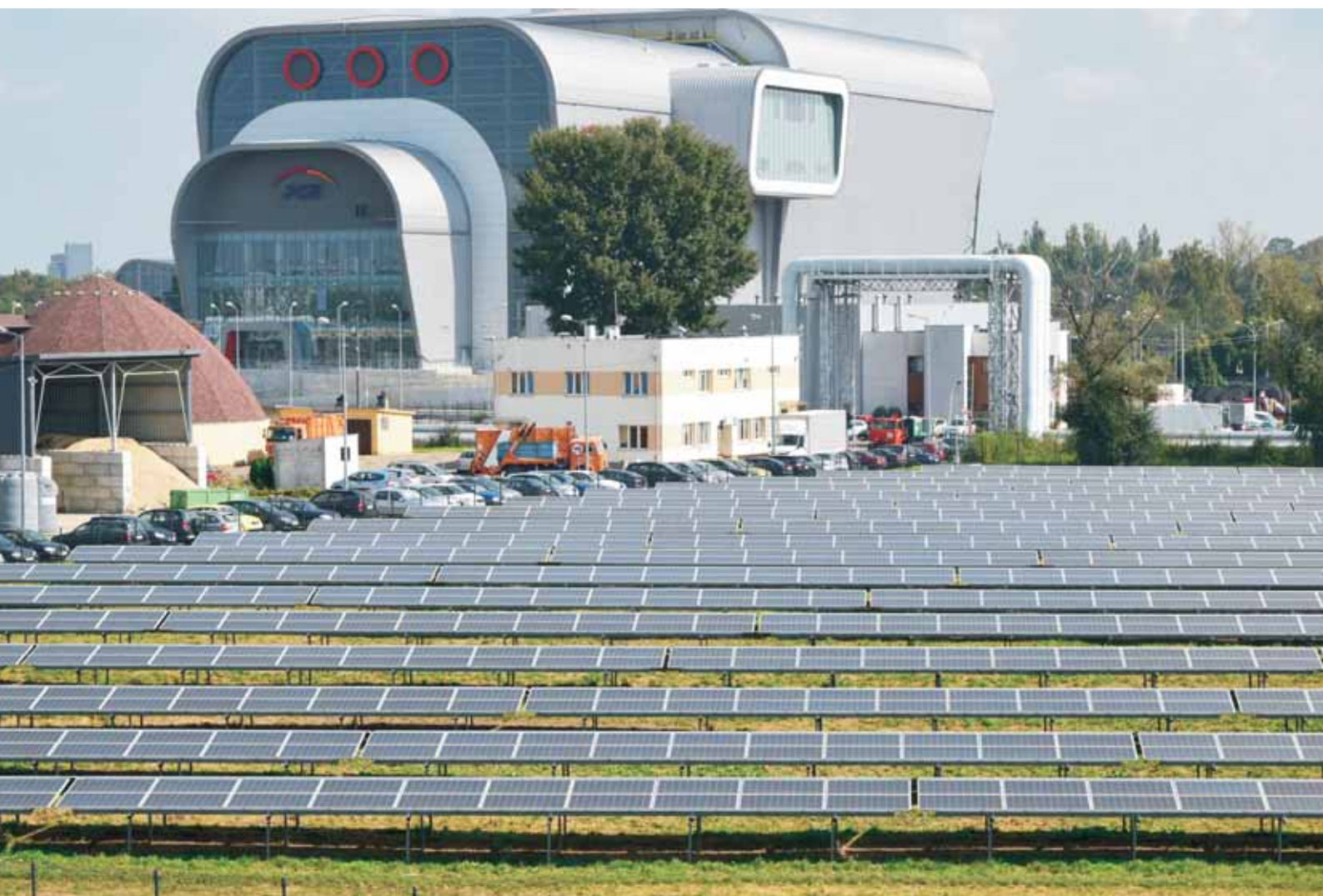
Widok na farmę fotowoltaiczną
