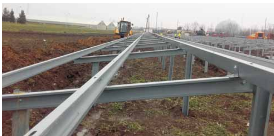
Konstrukcja wsporcza pod panele fotowoltaiczne
